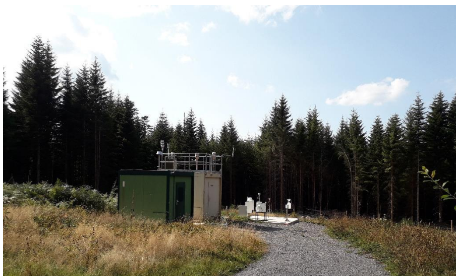
Figure 8 : Site du Donon en 2018 après finalisation des travaux et transfert du programme de mesure de Jonville
